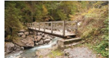
Über reissenden Fliessgewässern wird auf Wanderwegen ein beidseitiges Geländer empfohlen.
